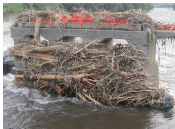
洪水時の流木でふさがった下井手取水堰(大津町)立野ダムの「穴」もこのようにふさがってしまうことが容易に想定できる 2012年7月15日撮影
