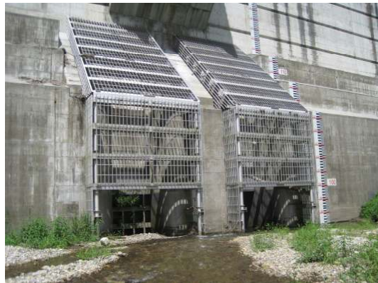
穴の上流部はスクリーンで覆われている
