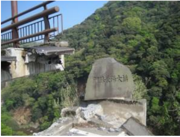
長陽大橋の石碑も崩落寸前です。
