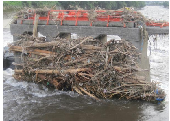
洪水時の流木でふさがった下井手取水堰(大津町) 2012年7月15日撮影
